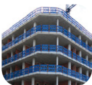
BARANDAS DE PROTECCIÓN
